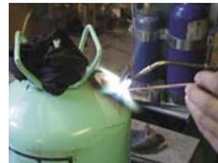
Место соединения штатного вентиля с баллоном обмотать мокрой тканью для отвода тепла
