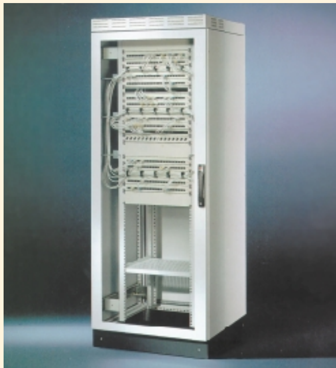
Рис. 5. Шкаф PROLINE с установленными сетевыми принадлежностями
