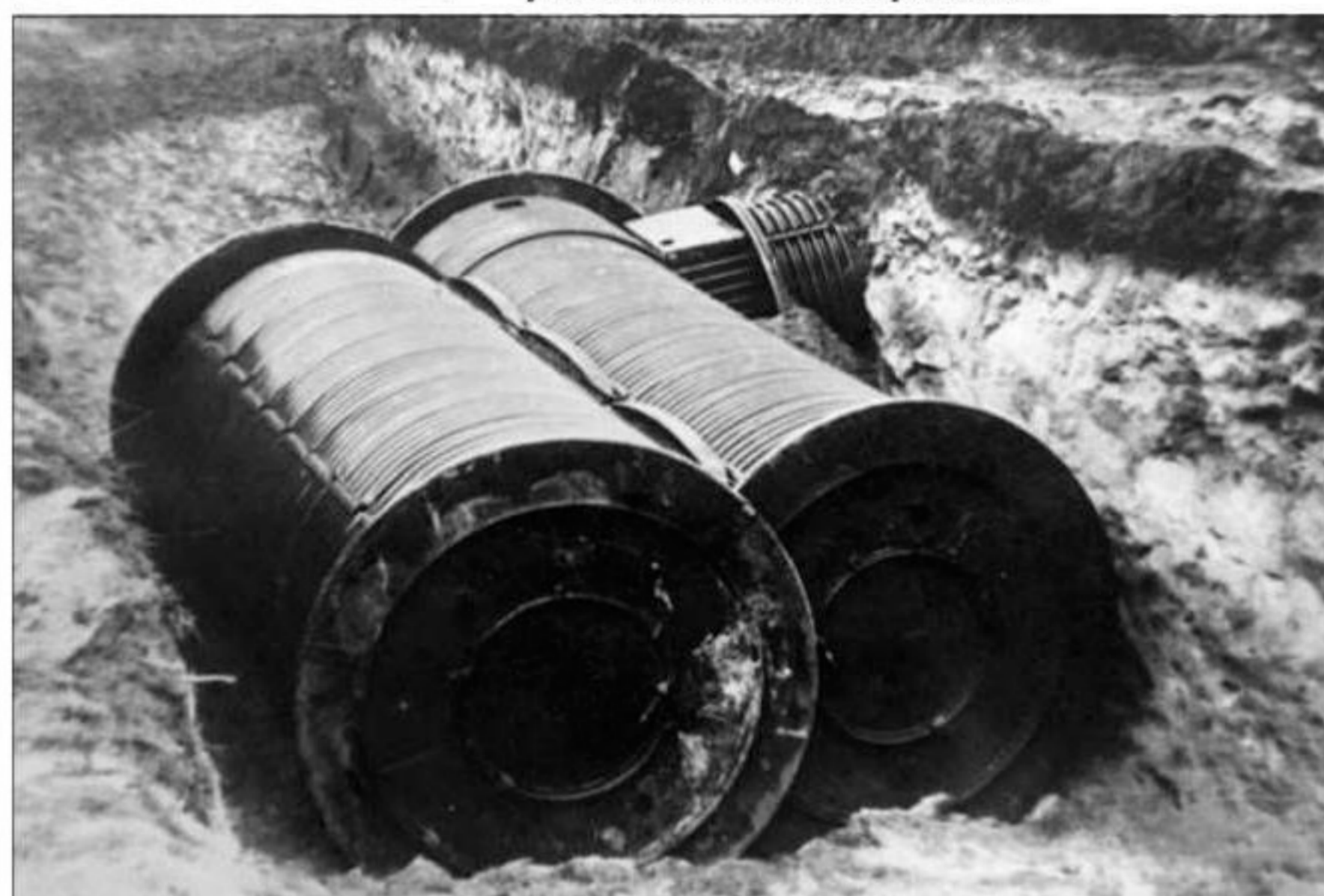
Общий вид состыкованных (в поперечном направлении) сооружений КВС-А в котловане с использованием рамы сопряжения.
