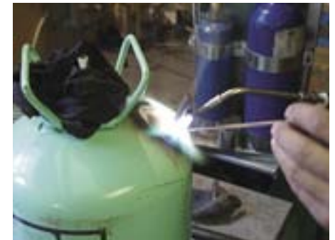
Место соединения штатного вентиля с баллоном обмотать мокрой тканью для отвода тепла
